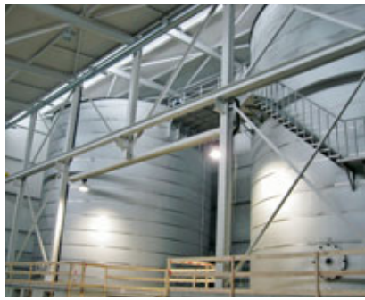
Abb. 6 Pumpenvorlagebehälter 2 x 700 m 3 in St. Gallen (Schweiz)
