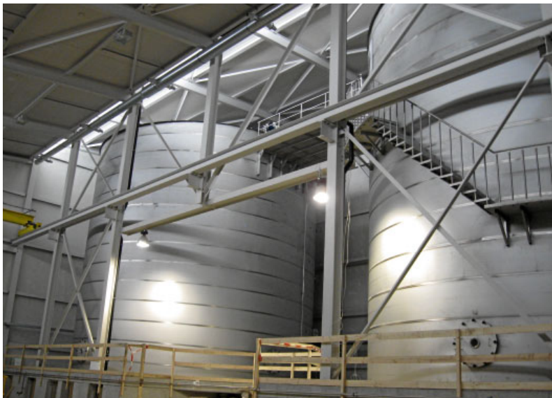
Bild 7. Pumpenvorlagebehälter 2 x 700 m 3 in der Schweiz (St. Gallen).
