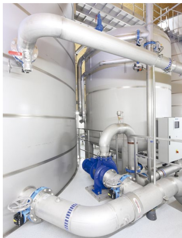
Bild 5. Wasseraufbereitung mit Rückspülpumpe. © Ing.-Büro WASSERMÜLLER ULM GmbH
