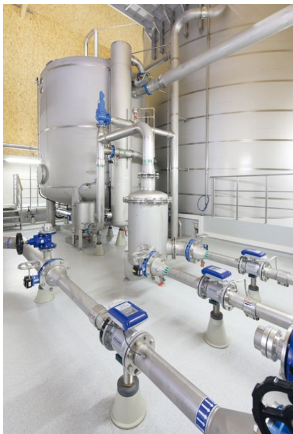
Bild 1. Wasseraufbereitungsanlage mit Zwischenbehälter. © Ing.-Büro WASSERMÜLLER ULM GmbH
