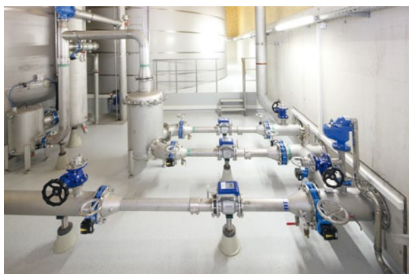
Bild 2. Mischbehälter. © Ing.-Büro WASSERMÜLLER ULM GmbH
