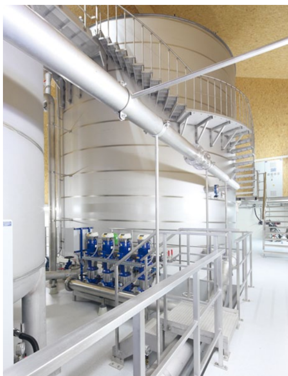
Bild 4. Druckerhöhung mit Behälteranlage. © Ing.-Büro WASSERMÜLLER ULM GmbH
