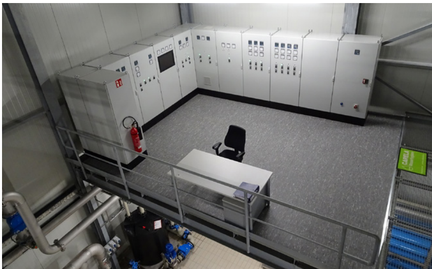
Abb. 7 – Die aus elf Feldern bestehende Schaltanlage sorgt für einen sicheren Anlagenbetrieb.
