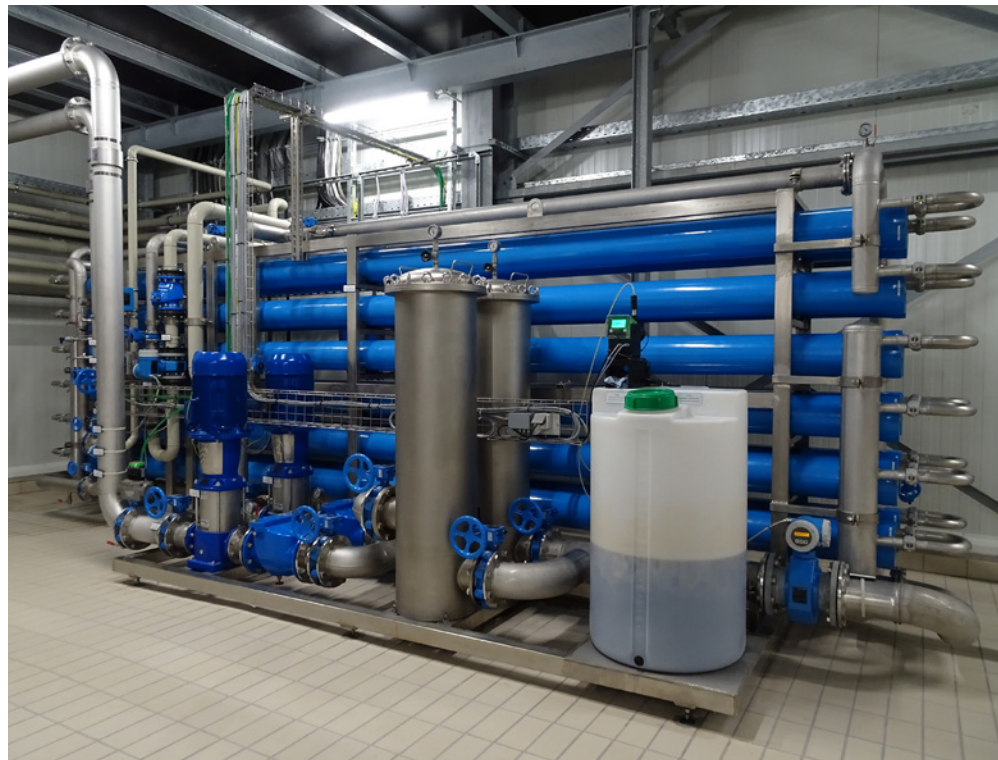
Abb. 3 – Nanofiltrationsanlage, mit der einem Teilstrom die Härte vollständig entzogen wird
