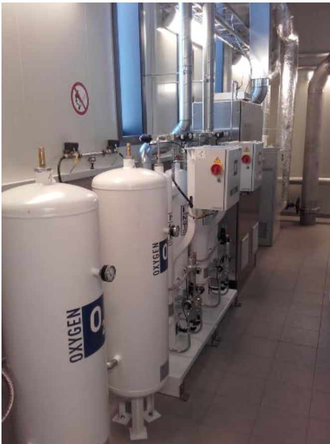
Bild 5: Sauerstoff- und Ozonerzeugungsanlage
