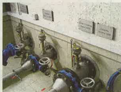
Rohrsystem gewährleistet die Versorgung von 700 Bürgern mit Wasser.
