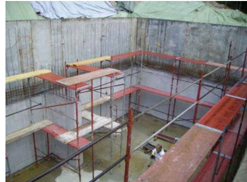
Bereits seit Mai wird am Aufstellungsort des neuen zweiteiligen Hochbehälters zur Wasserversorgung von Gosau gearbeitet. Bild: Wassergenossenschaft Hornquelle
