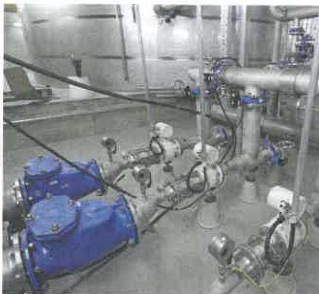
Das Rohrleitungssystem im Innern des Gebäudes.
