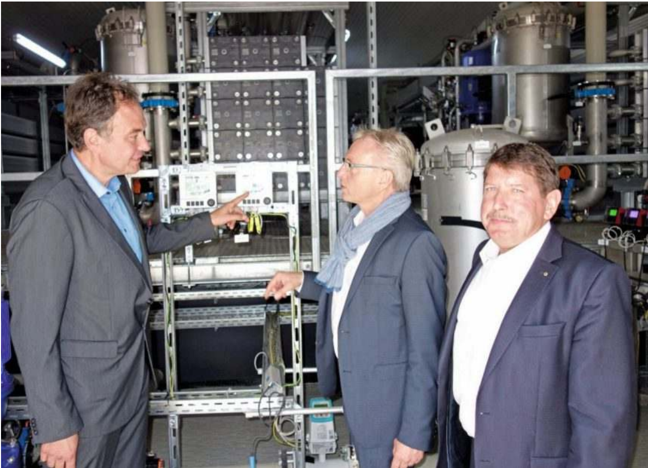
📹 Neue Technik: Stadtwerke-Abteilungsleiter Peter Riedinger, Bürgermeister Alexander Uhlig und Stadtwerke-Chef Helmut Oehler (von links) werfen einen Blick in die Anlage zur Aufbereitung des Trinkwassers. | Foto: Rudolphi
