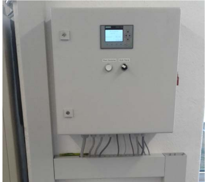
Steuerschrank mit Touch Panel
