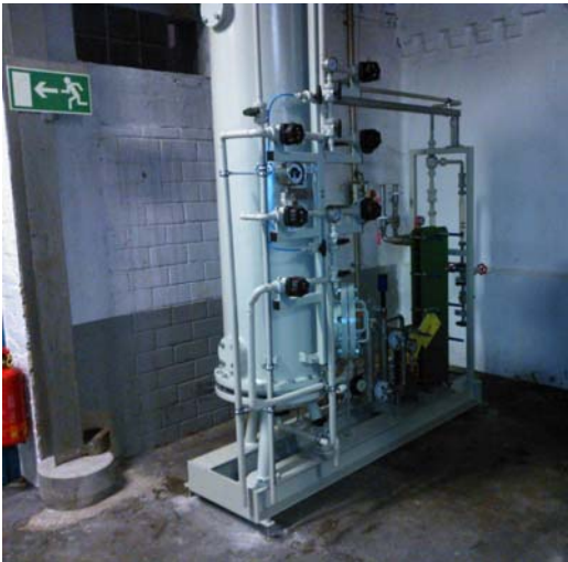
Komplette Anlage mit der erforderlichen Instrumentierung
