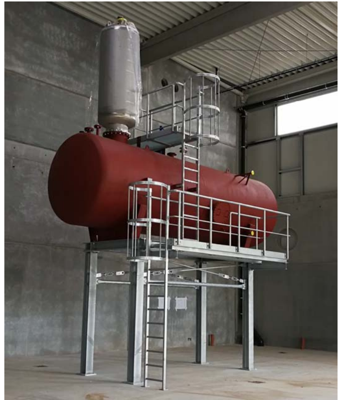
Entgasungsanlage nach der Aufstellung
