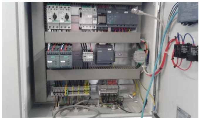
Innenansicht des Steuerschranks
