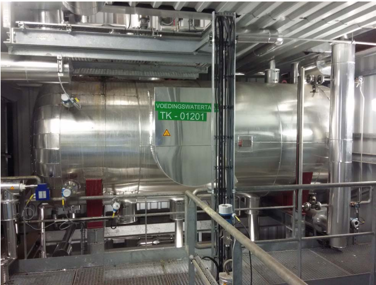
Entgasungsanlage nach kundenseitiger Installation und Isolierung
