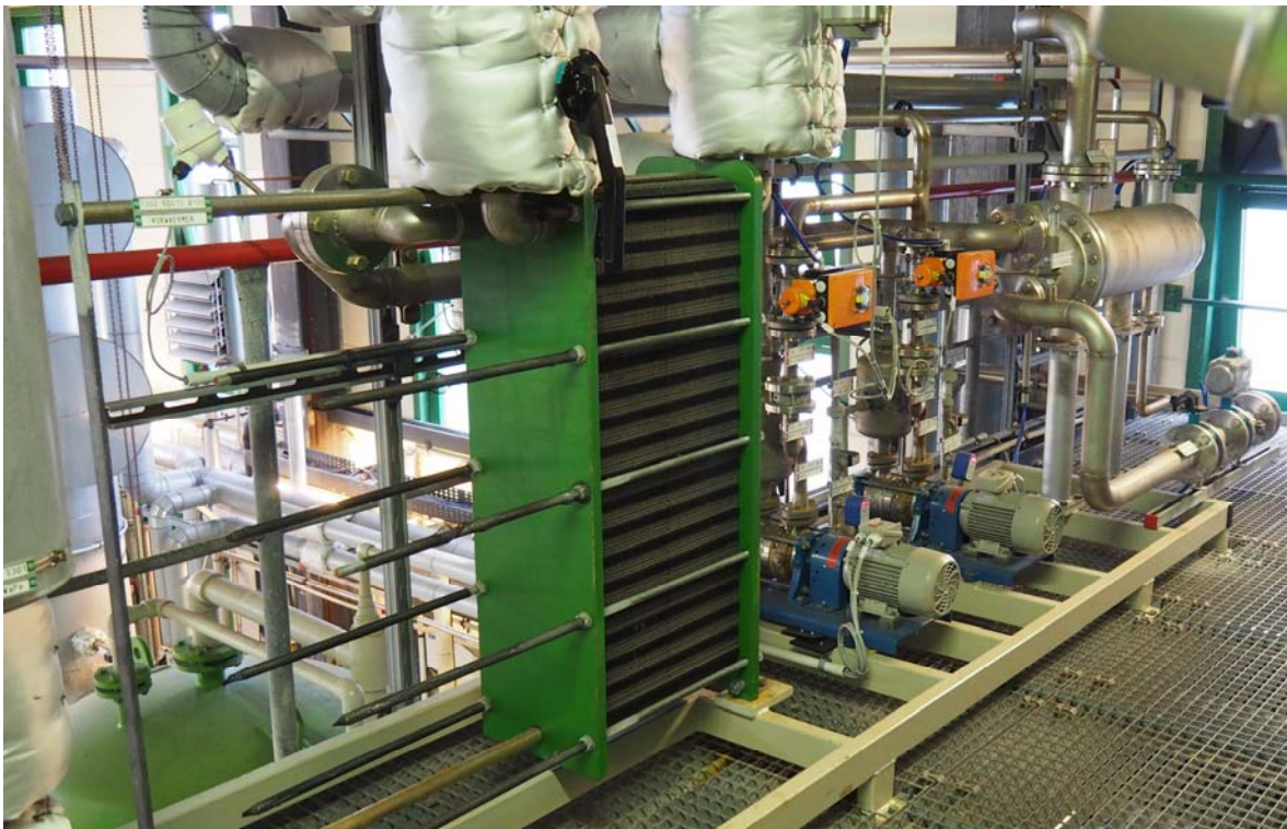
Gestell mit Brüdenkondensator, Vakuumpumpen und zusätzlichem Vorwärmer für das Speisewasser (v.r.)
