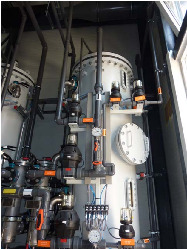
Kationenaustauscher als Verbundschwebbett
